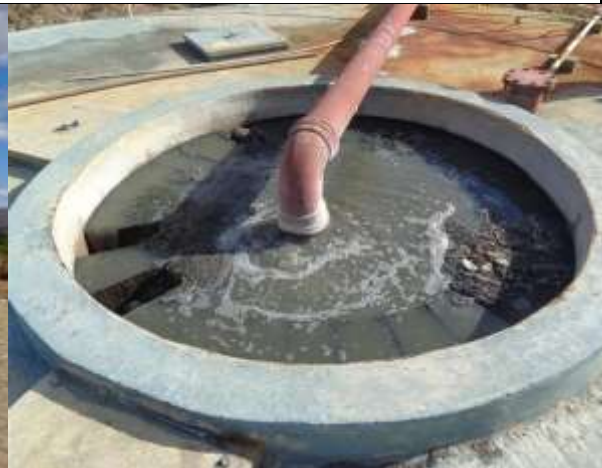
Foto 7 Entupimento dos distribuidores de esgoto do reator UASB
