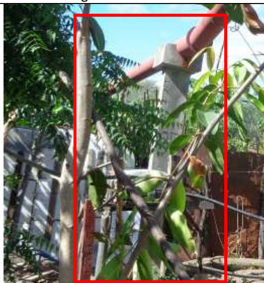
Foto 9 Pilar de sustentação do interceptor tombado
