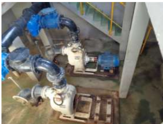
Foto 3 Ausência de bomba reserva instalada
