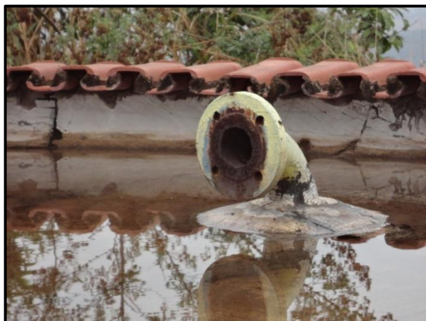
Foto 12: Tubo de ventilação sem embocadura voltada para baixo e tela de proteção no RAP - 02
