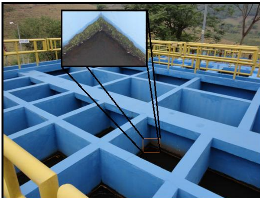
Foto 03: Musgo acumulado nas paredes do floculador.
