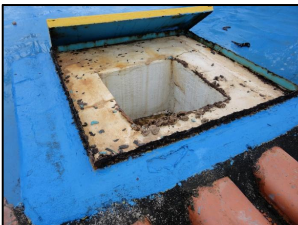
Foto 13: Avançado processo de ferrugem nas bordas da tampa.
