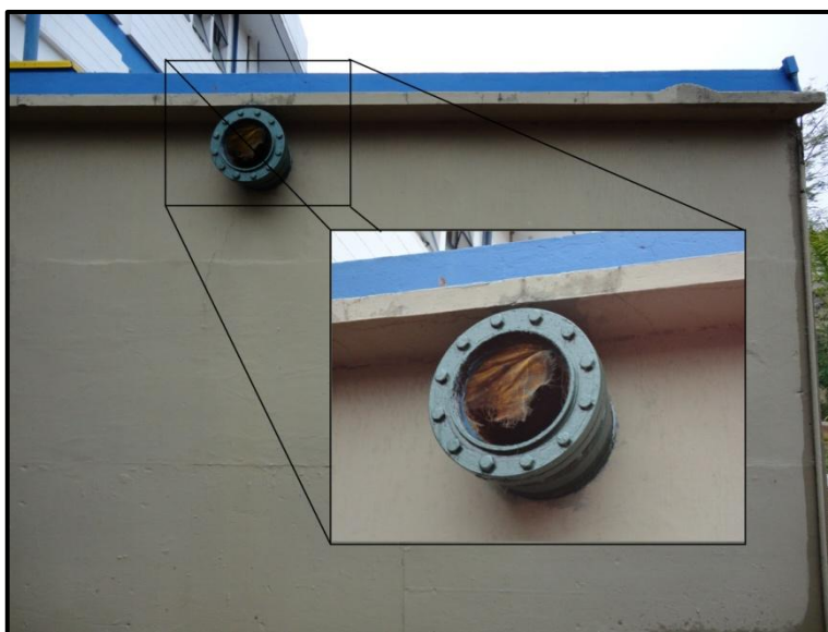
Foto 10: Tela da ventilação do tanque de contato danificada
