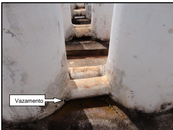
Foto 04 – Vazamento no Floculador
