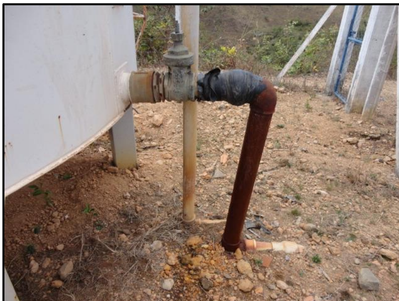
Foto 15: Tubulação de saída com vedação improvisada
