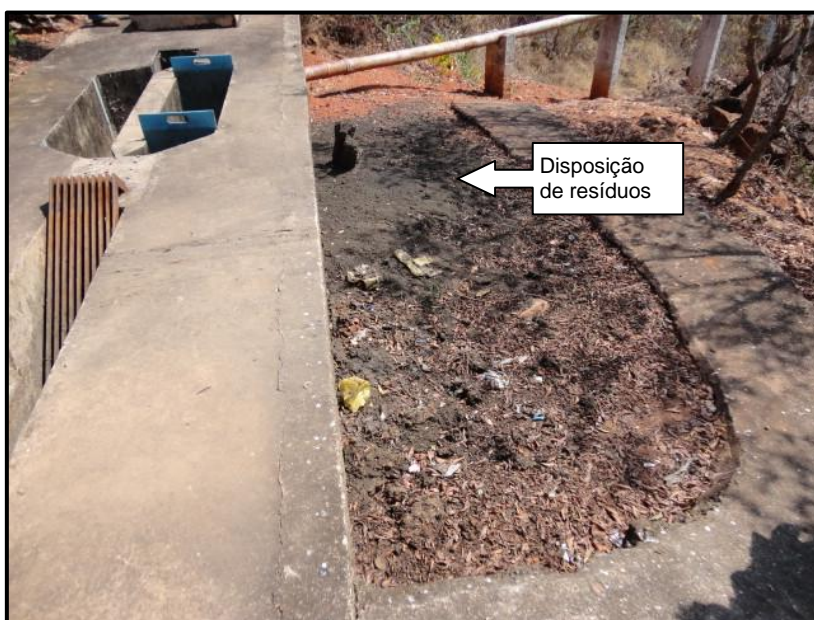
Foto 21: Disposição inadequada de resíduos do tratamento preliminar
