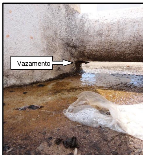
Foto 05 – Vazamento no Floculador
