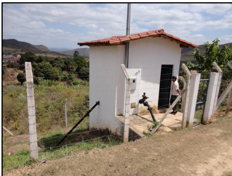
Foto 16: Entrada da EEAT-02 sem sinalização e identificação
