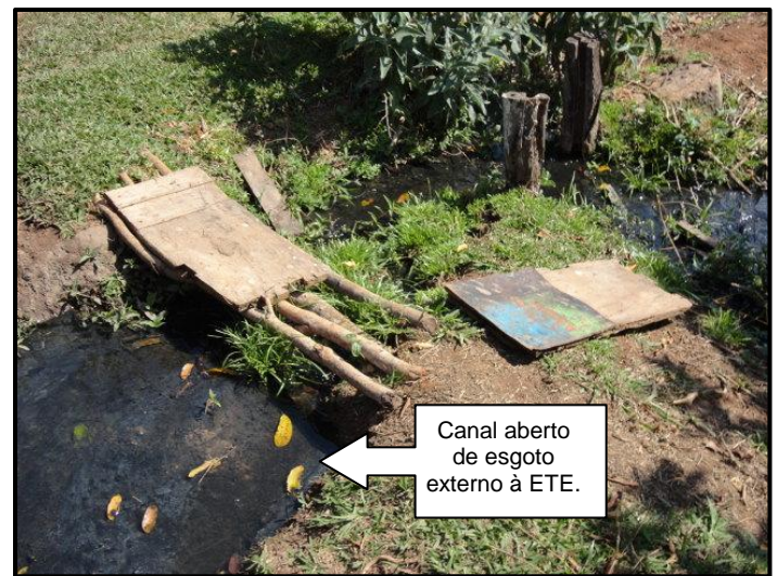
Foto 19: Canal aberto de esgoto tratado, com sinais de septicidade
