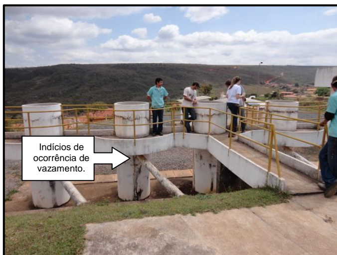
Foto 06 – Filtro com indícios de vazamento
