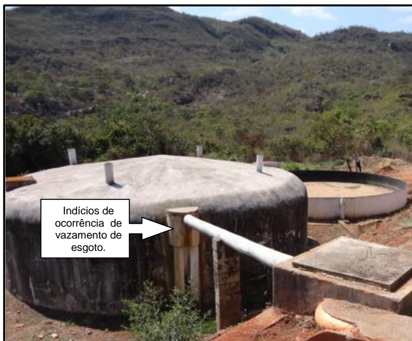
Foto 27: Má conservação do filtro anaeróbio
