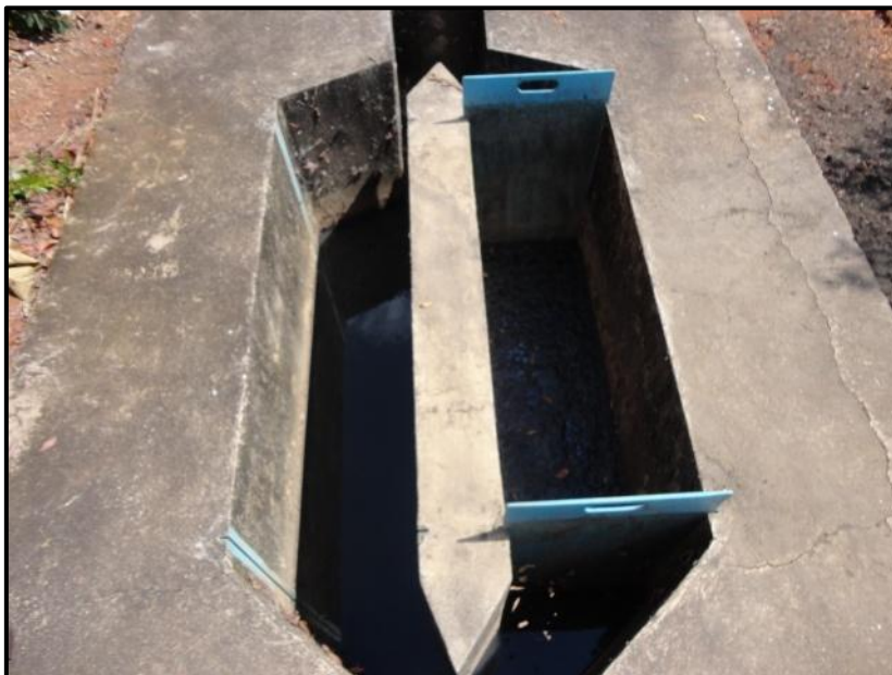
Foto 20: Desarenador necessitando de limpeza.
