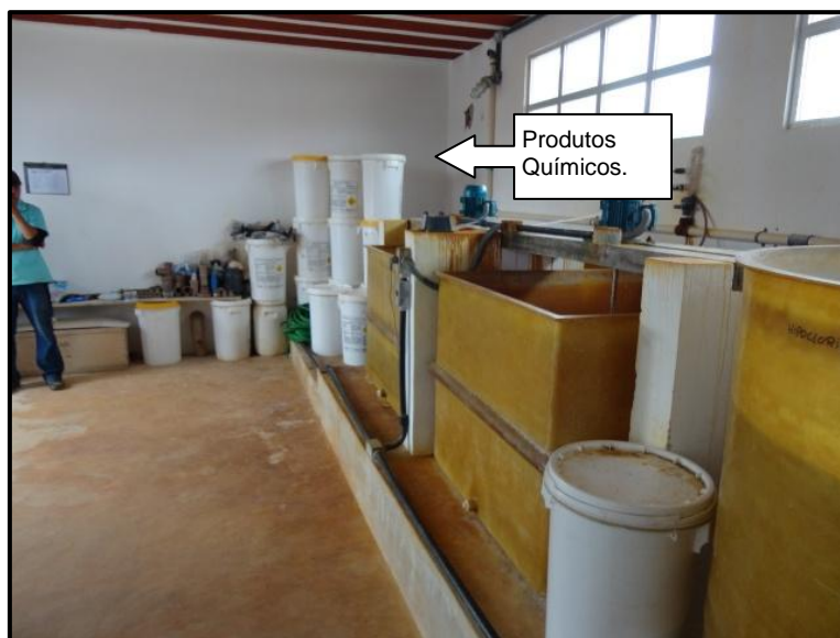
Foto 08 – Falta de almoxarifado para acondicionamento dos produtos químicos.
