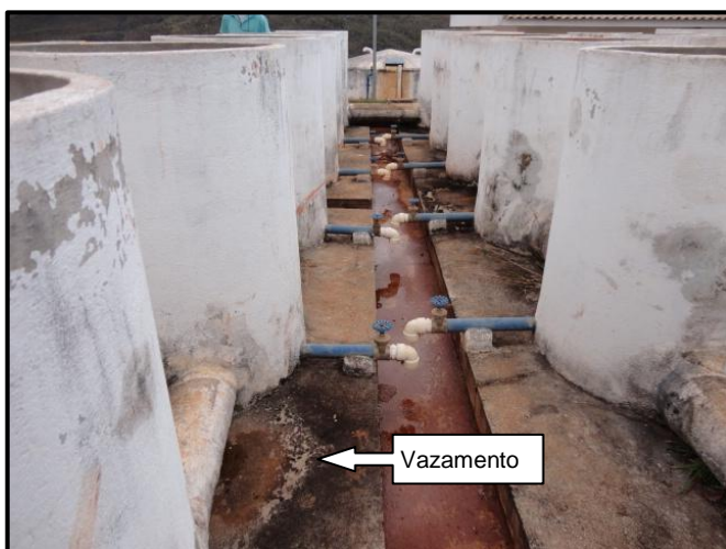
Foto 02 – Vazamento no Floculador
