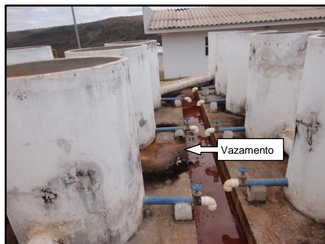
Foto 03 – Vazamento no Floculador
