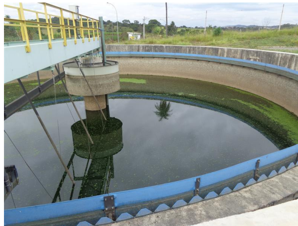
Foto 4. Decantador inoperante (C2.2)
