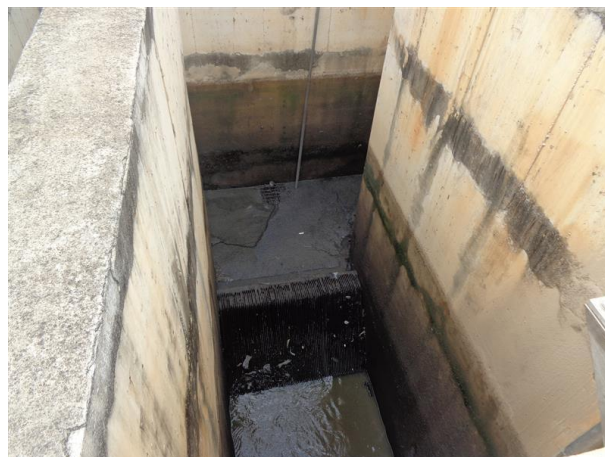
Foto 2. Poço de sucção da EEE final. É possível identificar o nível que o efluente alcança ao extravasar, quando a bomba desarma.
