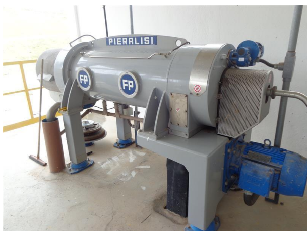
Foto 5. Centrífuga inoperante (C2.3)
