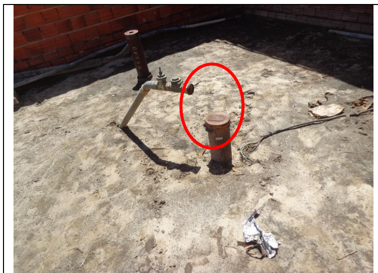
Foto 4 Poço fora de operação
