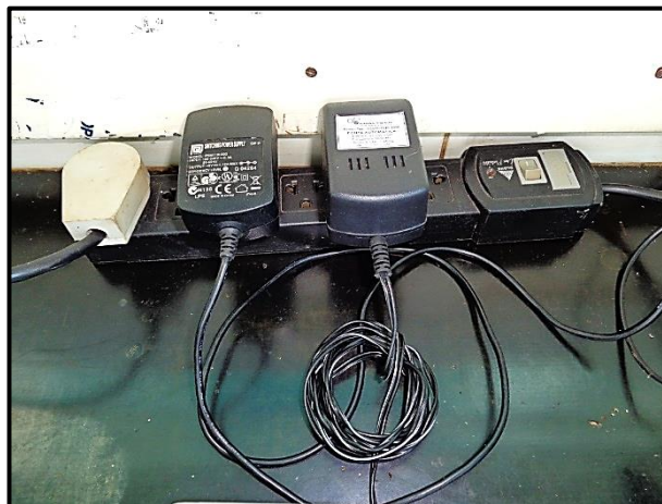
Imagem 5. Equipamentos conectados à uma mesma fonte de energia elétrica.
