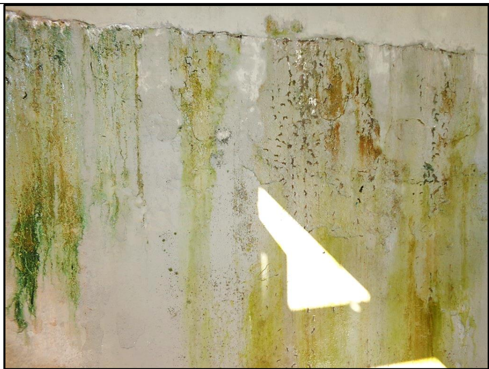
Foto 7. Vazamento na parede do tanque de contato.
