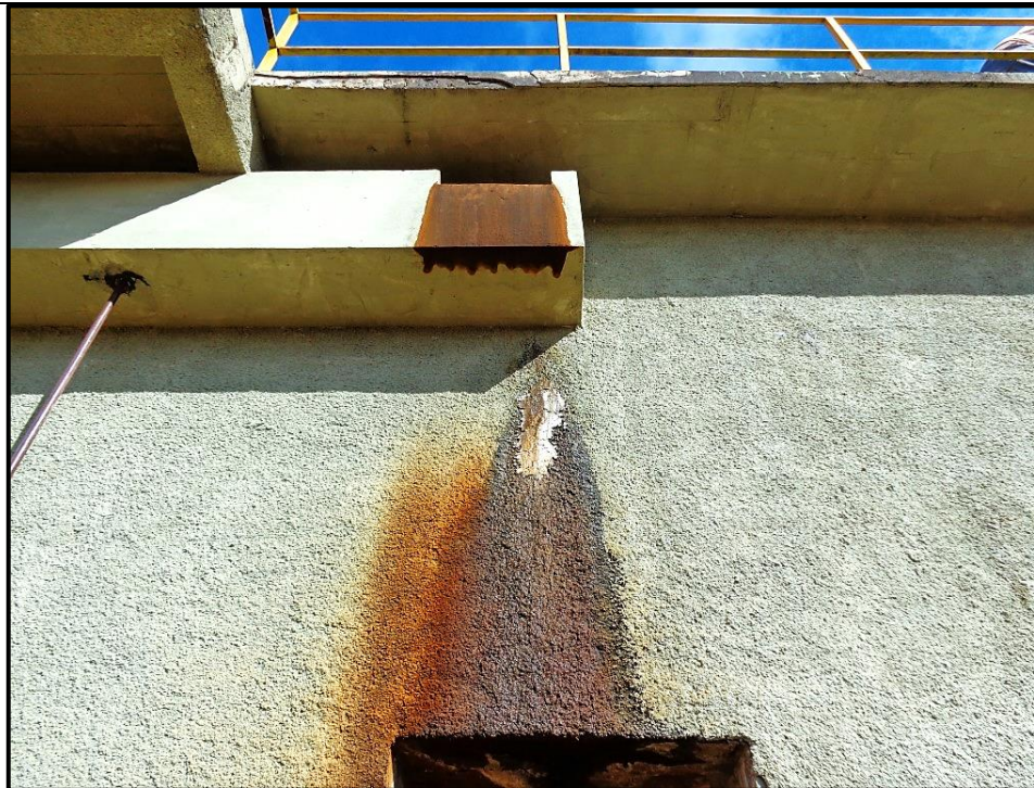
Foto 3. Vazamento na parede dos filtros.
