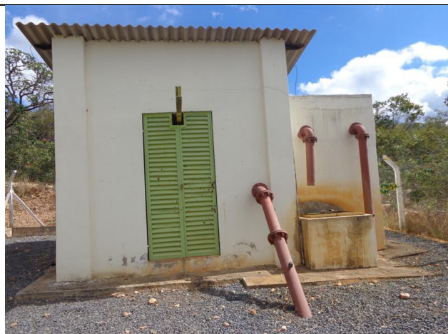
Foto 7. Ausência de placa de identificação na Estação Elevatória de Água Bruta EEAB 2.
