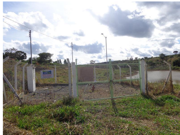
Foto 6. Ausência de placa de identificação no Poço E-01.
