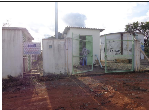
Foto 8. Ausência de placa de identificação na Elevatória de Água Tratada junto ao RAP R3.
