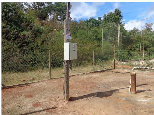
Foto 3. Quadro de comando em estrutura de madeira improvisada.
