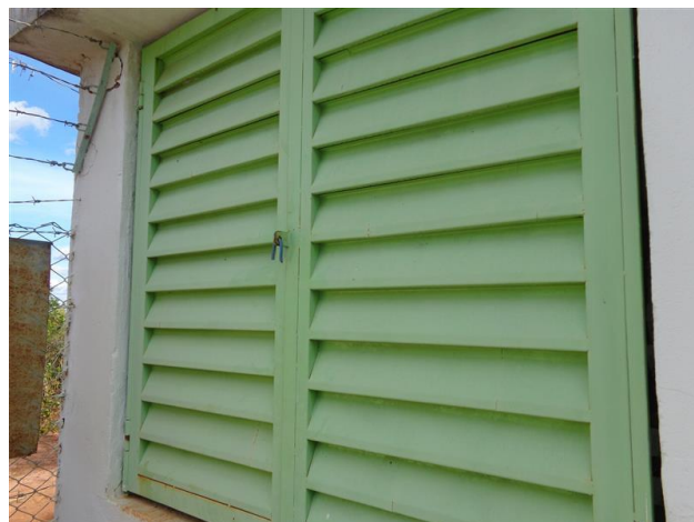
Foto 4. Ausência de cadeado
