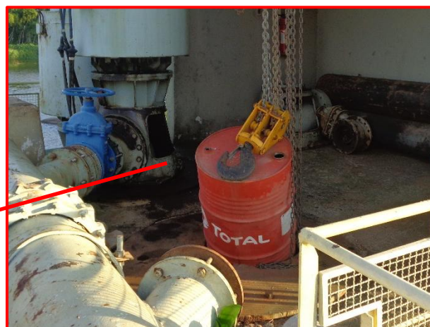
Foto 2. Localização onde deveria estar instalada a bomba reserva (C1.1)
