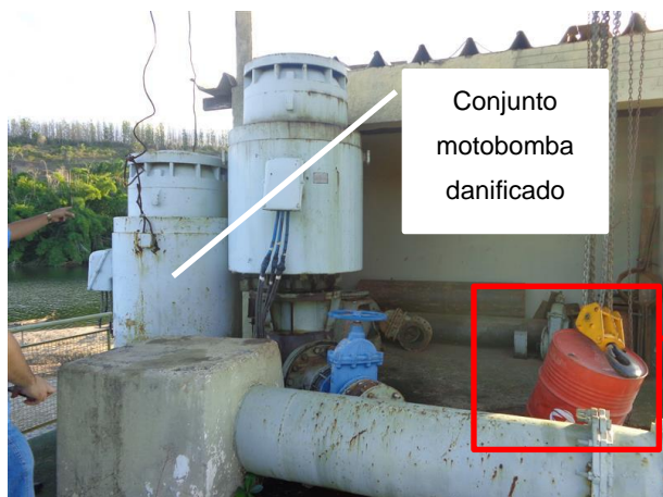
Foto 1. Conjuntos motobomba da torre de tomada de água no rio Mucuri (C1.1)
