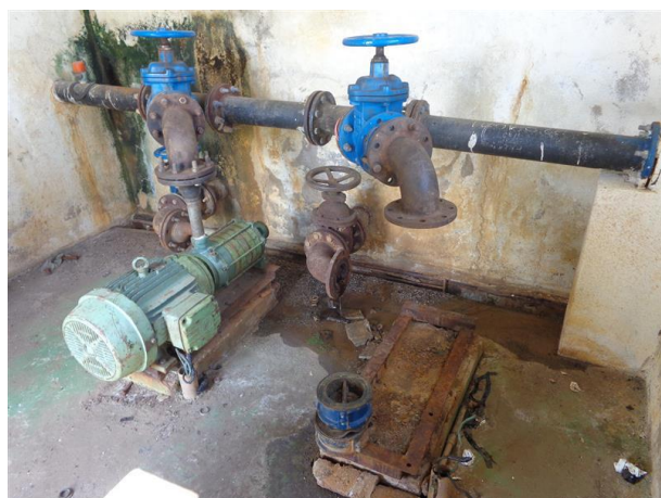
Foto 6. Ausência de bomba reserva (C1.3)
