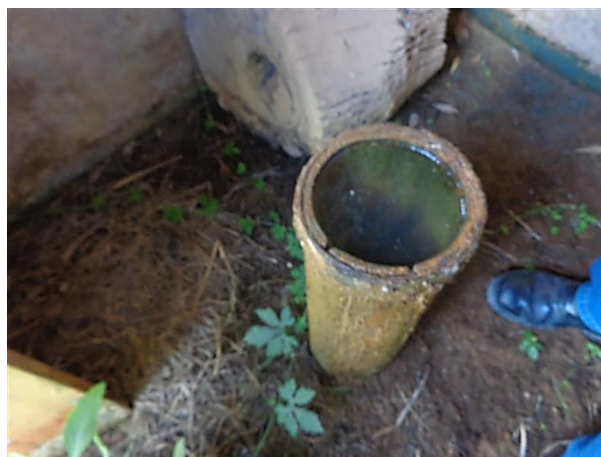
Foto 8. Poço C-01 - Tubo de revestimento sem tampa (Recomendação 2)
