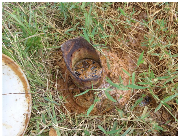
Foto 10. Poço C-03 - Tubo de revestimento em avançado processo de corrosão e sem tampa (Recomendação 2)
