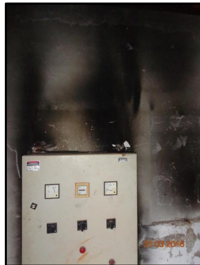
Foto 4. Marcas de fogo no interior da EAB
