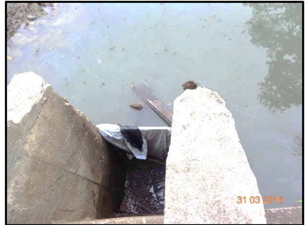
Foto 2. Estrutura madeira, que faz a retenção de água na barragem, danificada.
