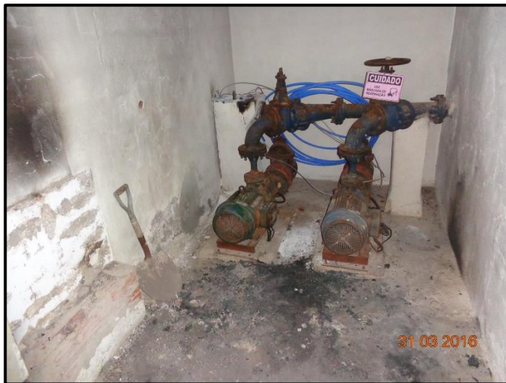
Foto 3. Marcas de fogo no interior da EAB
