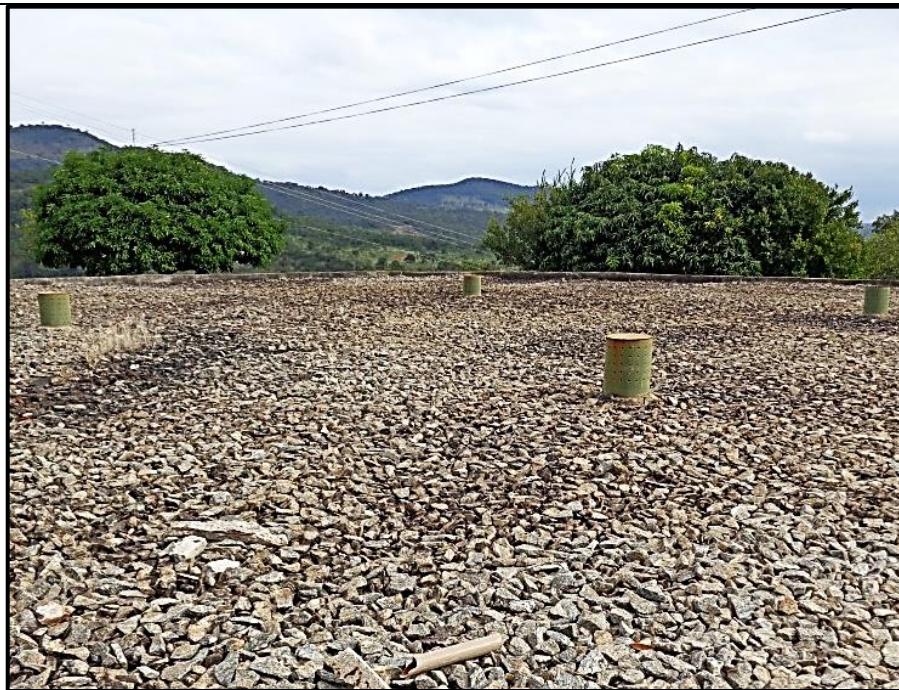
Foto 2. Dutos de ventilação do R1.
