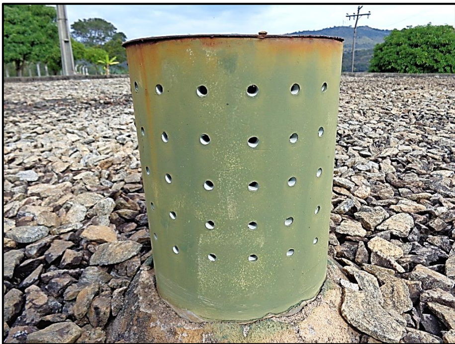
Foto 3. Duto de ventilação do R1.
