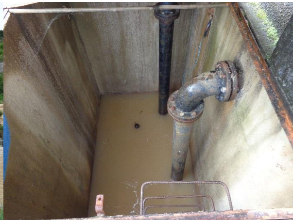
Imagem 6. Poço de sucção – Córrego São José
