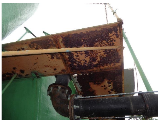
Imagem 3. A passarela de acesso entre as unidades está oxidada em diversos pontos
