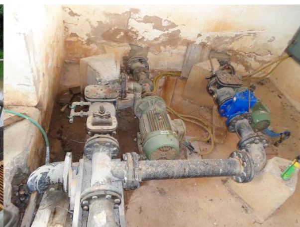
Imagem 8. Conjuntos motobomba da elevatória de água bruta – Córrego São José
