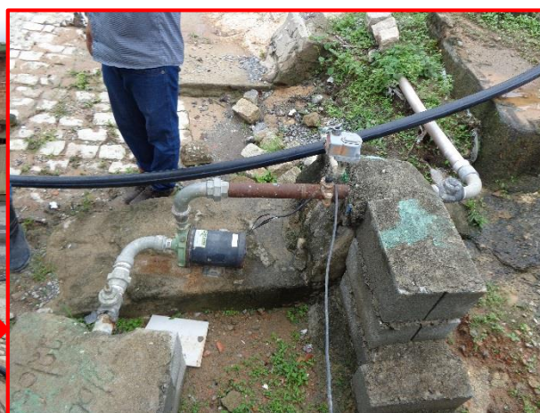
Imagem 13. Elevatória de água tratada "provisória" exposta na via pública
