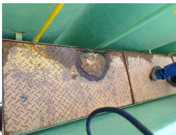
Imagem 4. Passarela de acesso entre as unidades está oxidada em diversos pontos
