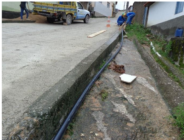
Imagem 14. Instalação de rede distribuída em uma rua, com um caminhão e trabalhadores visíveis no fundo.
