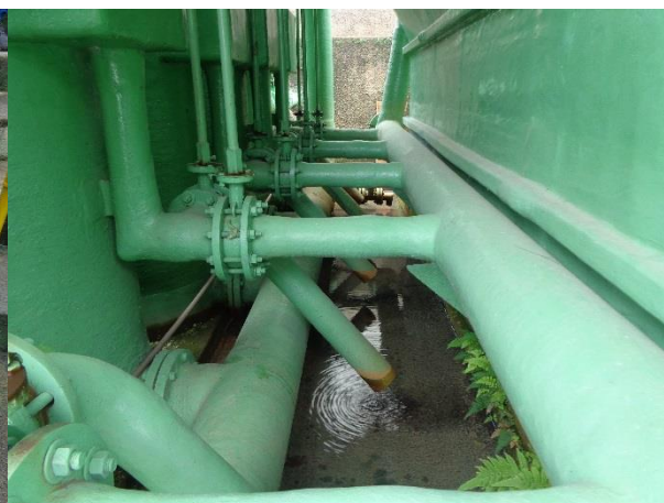
Imagem 2. Vazamento no registro de descarga
