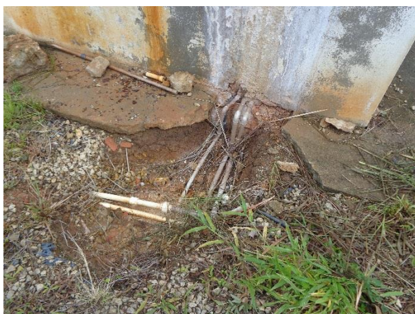
Imagem 1. Poço tubular profundo C 02 - Santa Cruz
