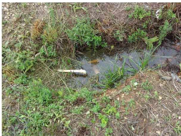
Imagem 3. Água empossada de manutenção corretiva realizada recentemente.
