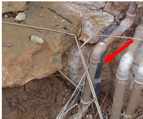
Imagem 2. Cabo de eletricidade ao lado de tubulação que rompe frequentemente
