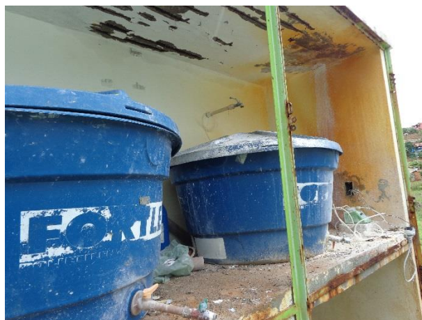
Imagem 4. Reservatórios de reagentes químicos não identificados. Teto corroído. Espaço desorganizado
