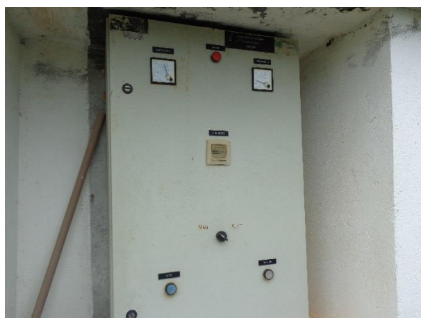
Imagem 6. Quadro de comando desprotegido. Não há porta
