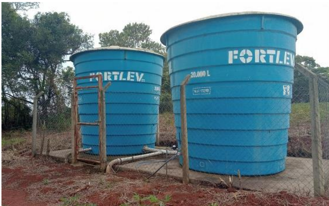
Reservatório REL-09 e REL-10 – Alto das Cruzes
