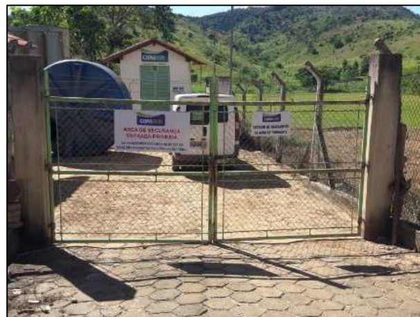
Foto 2. Elevatória de Água Tratada - EAT
