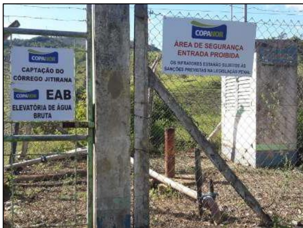
Foto 1. Elevatória de Água Bruta - EAB córrego Jitirana
