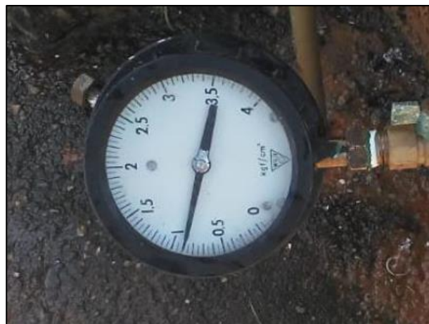
Foto 4. Rua Célio Moreira da Costa. Pressão de 9 m.c.a.
