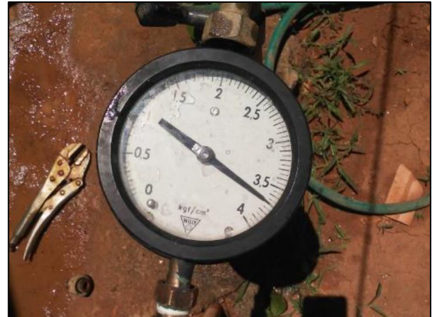
Foto 8. Rua da Torre. Pressão de 37 m.c.a.
