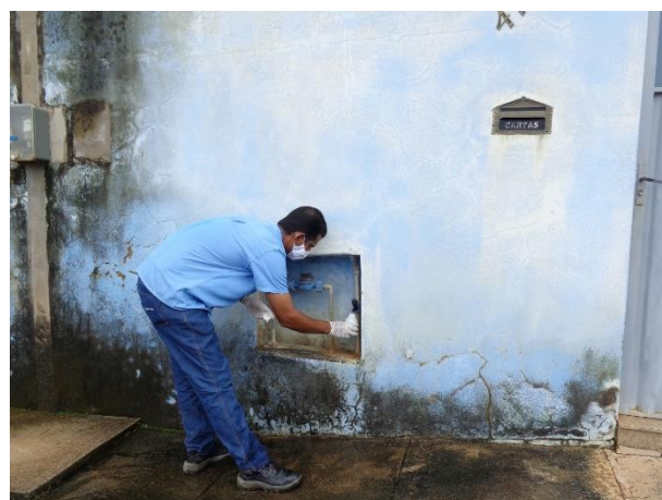
Foto 6. Ponta de rede na Rua Saturnino, nº 417
