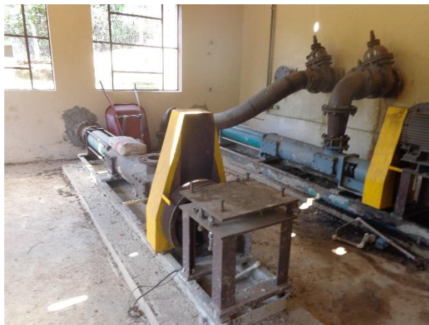
Imagem 3. EEE 01 - Estação elevatória de esgotos Novo Horizonte,
