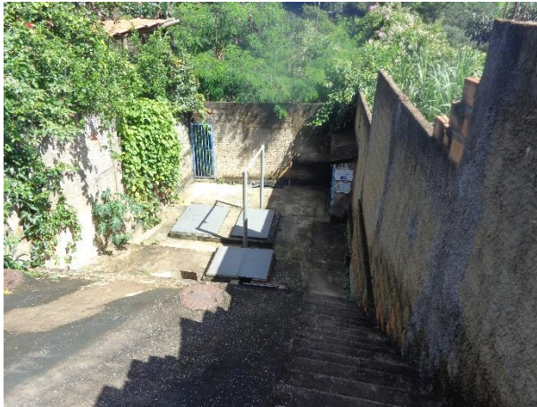
Imagem 7. EEE - Estação elevatória de esgotos Alto do Açude
