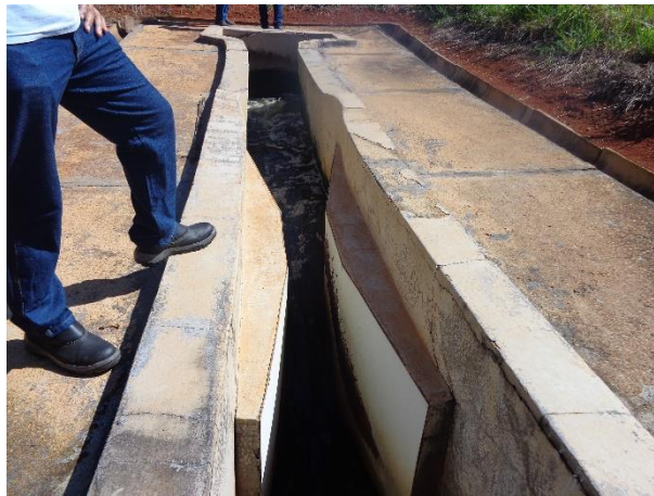
Imagem 15. Calha Parshall – Saída do tratamento
