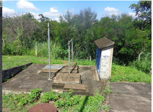
Imagem 8. EEE 06 – Estação elevatória de esgotos São Domingos
