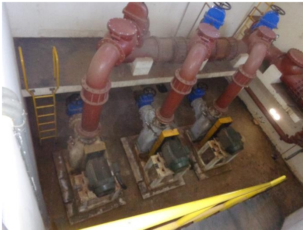
Imagem 9. Estação elevatória final de esgotos
