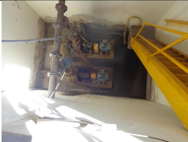
Foto 7. EEE Nossa Senhora Aparecida – fosso inundado
