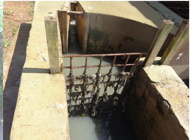
Imagem 2. EEE 01 – Gradeamento - Estação elevatória de esgotos Novo Horizonte,
