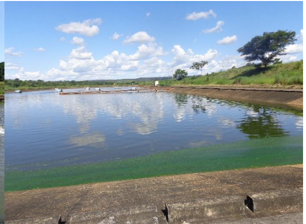
Imagem 14. ETE - lagoa aerada facultativa
