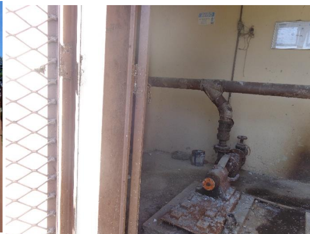
Foto 2 – Elevatória 04 – Esplanada –bomba em manutenção
