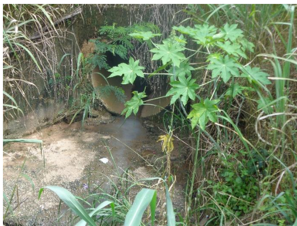
Foto 5 - Grota final da rua Travessa 18. Lançamento de esgoto na galeria pluvial
