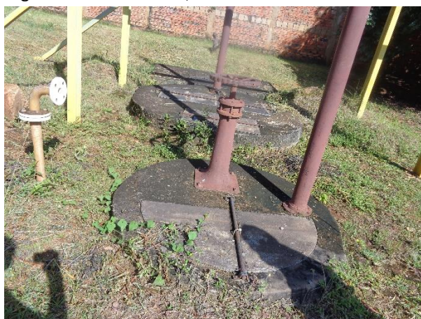
Imagem 5. EEE 03 - Estação elevatória de esgotos Alvorada
