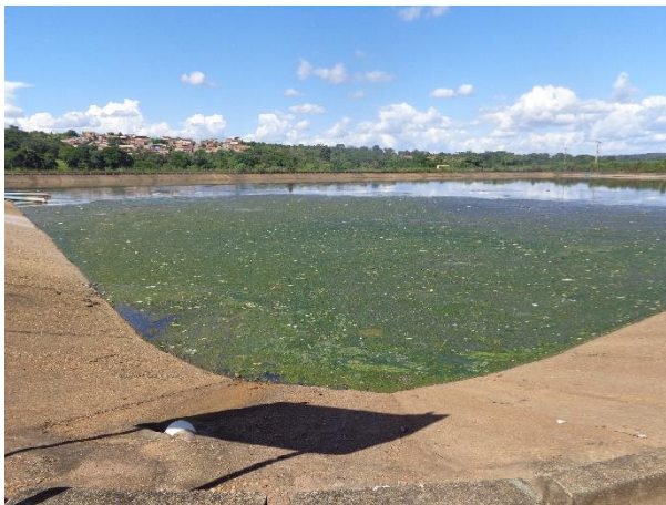
Imagem 11. ETE - Lagoa anaeróbia
