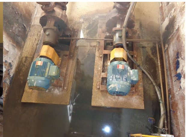
Imagem 4. EEE 02 - Estação elevatória de esgotos Nossa Senhora Aparecida
