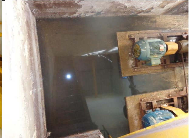
Foto 8. EEE Nossa Senhora Aparecida – fosso inundado
