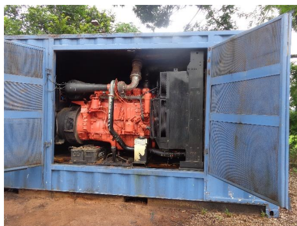
Foto 5. - Gerador de energia – Captação ribeirão Santa Isabel. .
