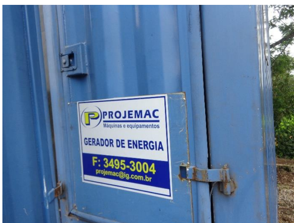
Foto 4- Gerador de energia – Captação ribeirão Santa Isabel. .
