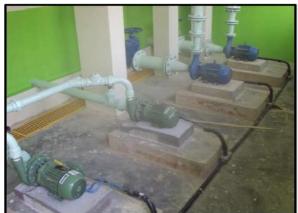
Foto 2. Elevatórias de água tratada
