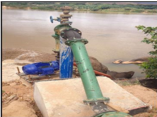
Foto 1. Captação no rio Jequitinhonha
