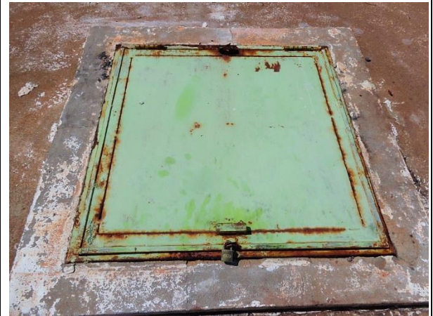
Foto 2. Má conservação da tampa de inspeção.
