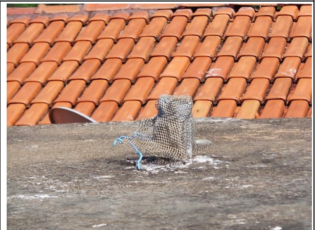
Foto 4. Duto de ventilação vulnerável à entrada de chuva.
