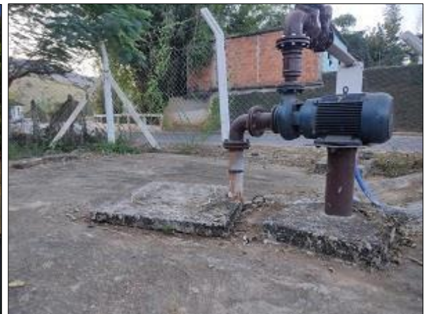
Foto 2. Poço de sucção
