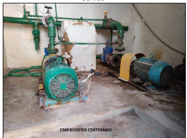
Foto 14. Booster Centenário - Conjunto moto-bomba retirado para manutenção
