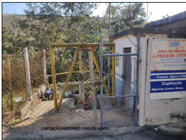
Foto 5. Captação e EAB Carlos Alves
