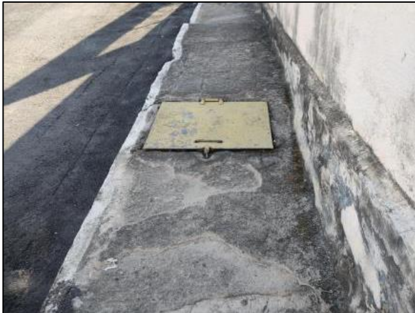
Foto 15. Booster Santo Antônio
