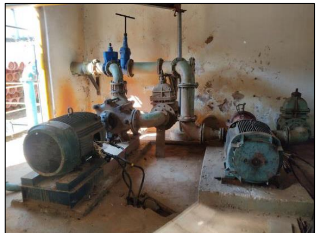
Foto 8. EAB Intermediária - Conjuntos moto-bomba
