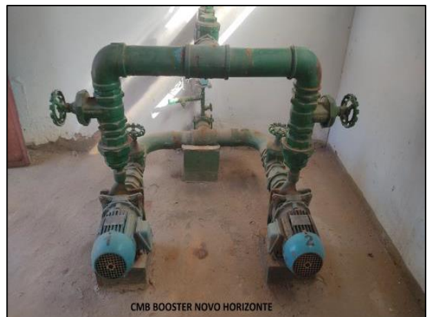
Foto 12. Booster Novo Horizonte - Conjuntos moto-bomba
