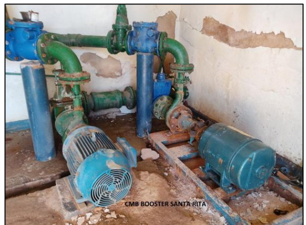
Foto 20. Booster Santa Rita - Conjuntos moto-bomba
