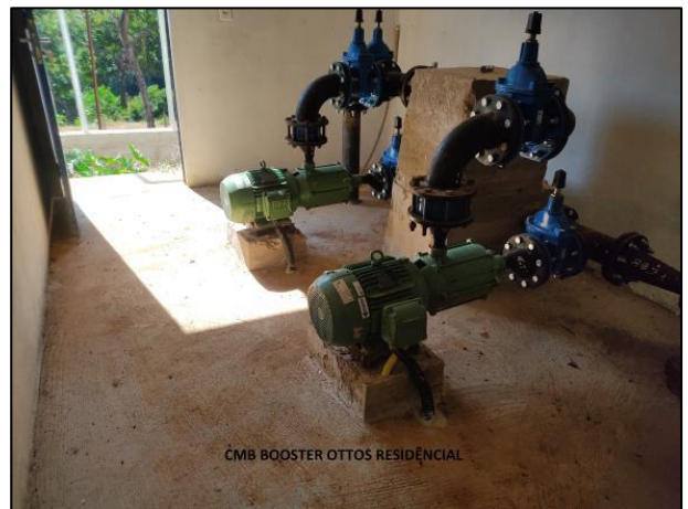
Foto 18. Booster Ottos - Conjuntos moto-bomba
