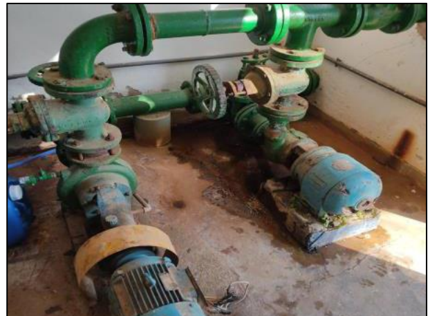
Foto 10. EAT ETA - Conjuntos moto-bomba
