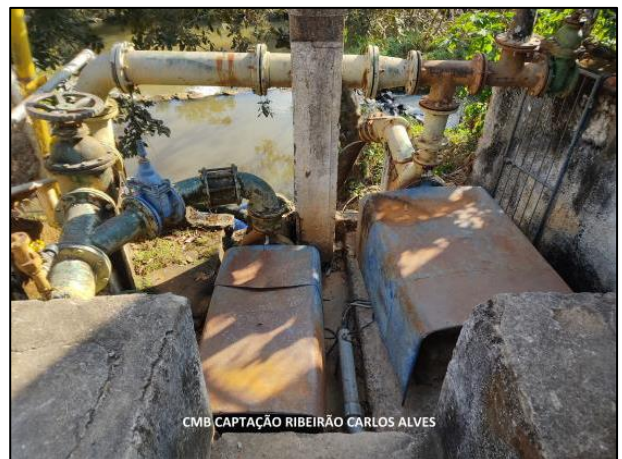
Foto 6. EAB Carlos Alves - Conjuntos moto-bomba
