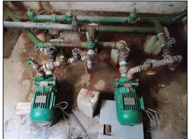
Foto 16. Booster Santo Antônio - Conjuntos moto-bomba
