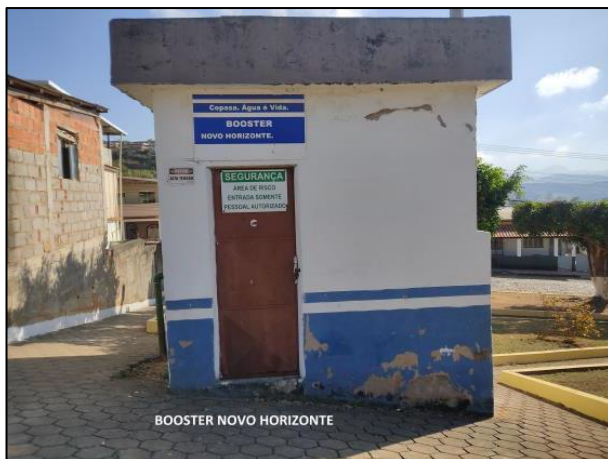
Foto 11. Booster Novo Horizonte
