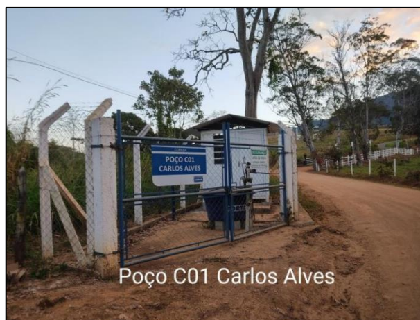
Foto 3. Fonte de captação
