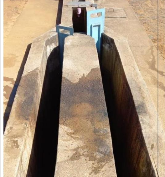
Caixa de areia - ETE
