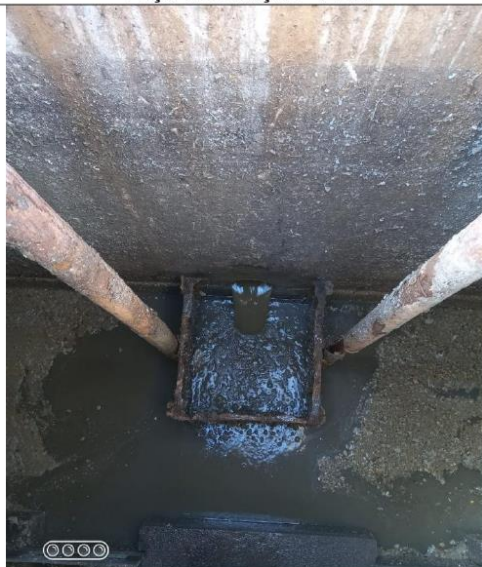
Cesto retenção sólidos grosseiros - EEE
