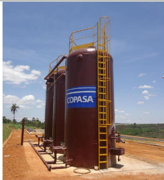
Reatores Anaeróbios (UASB) - ETE
