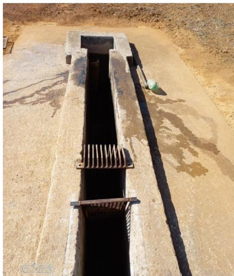
Tratamento preliminar - ETE
