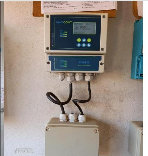
Medidor de vazão - ETE
