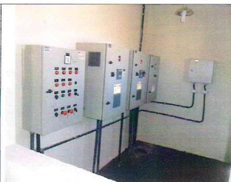
Quadro de comando - EAT 11 Booster
