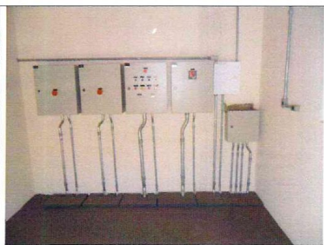
Quadro de comando - EAT 13
