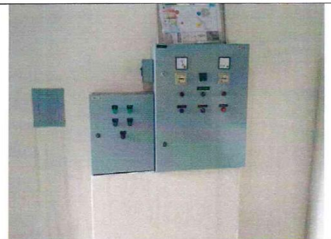
Quadro de comando - EAT 09
