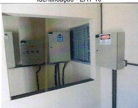
Quadro de comando - EAT 10
