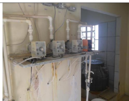
Sala de Dosagem - ETA
