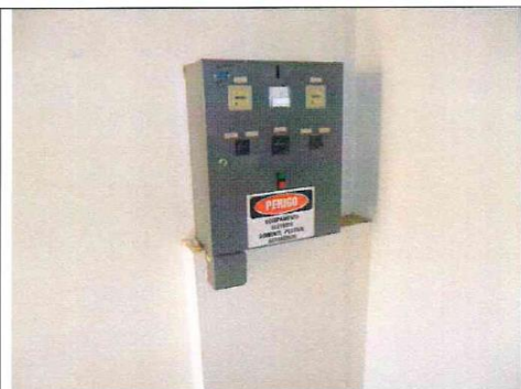
Quadro de comando - EAT 07
