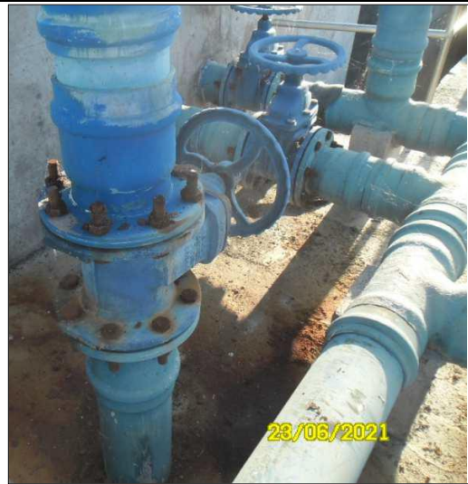
Foto 2. Registro de manobra travado
